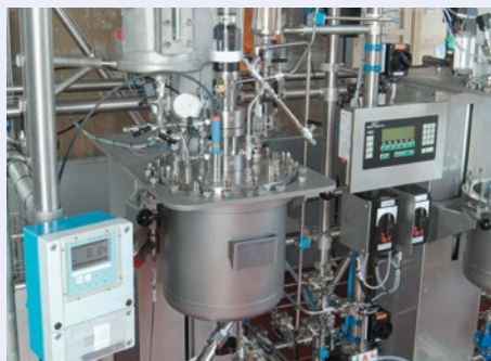
Control of suspension-polymerisation Steuerung Suspensions-Polymerisation
